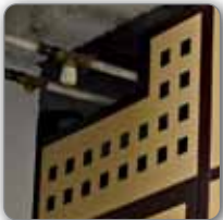
Přizpůsobení rozvodům ve sklepě
